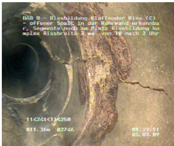
Beispielhaftes Schadensbild eines undichten Kanals
