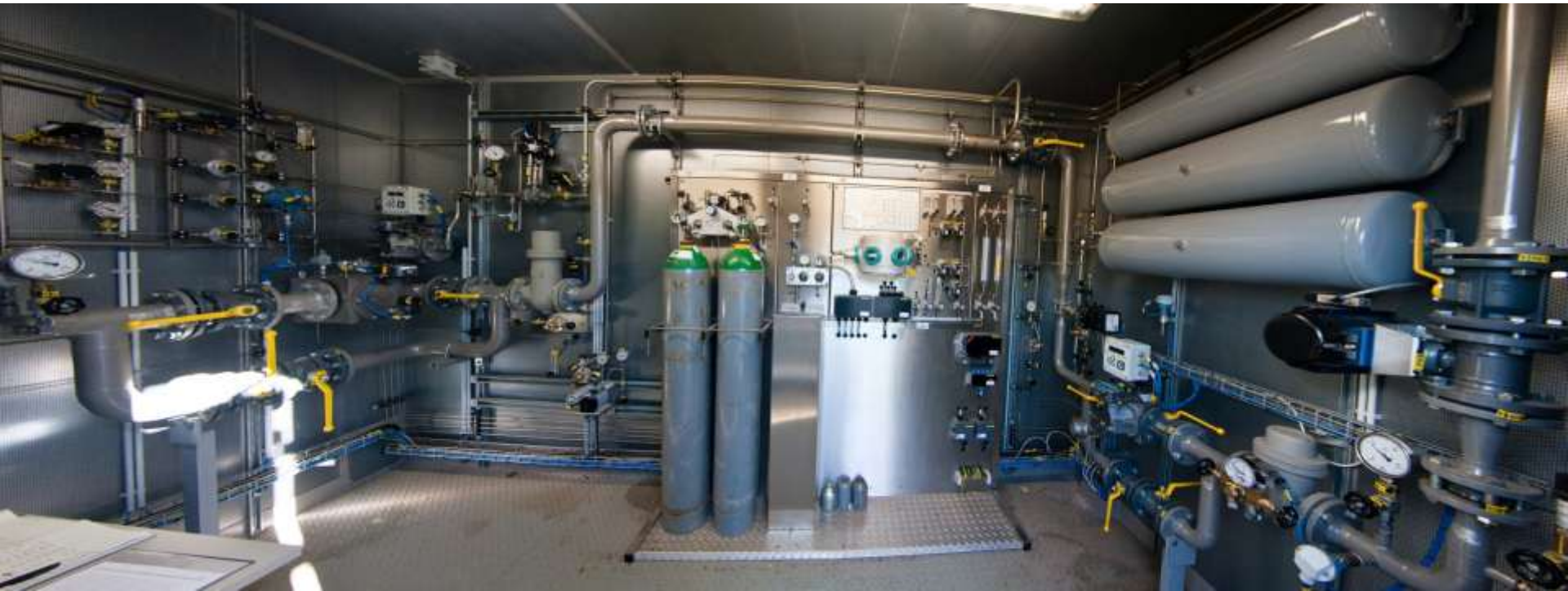
Panorama des Einspeisecontainers mit Prozessgaschromatograph
